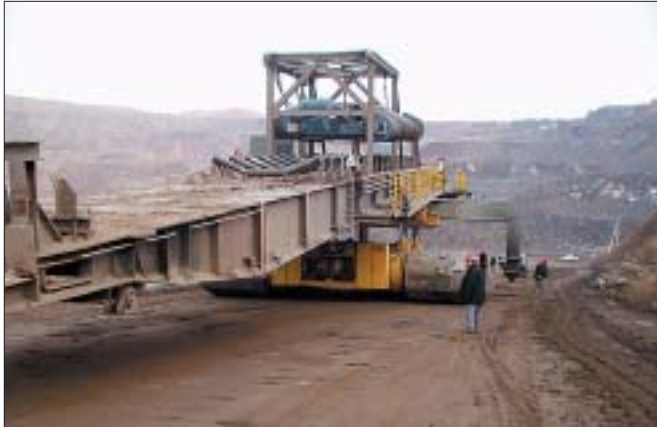
Fig. 12: Shifting the discharge conveyor by transport crawler T 850 Abb. 12: Transport des Austragsbandes mit der Transportraupe T 850
